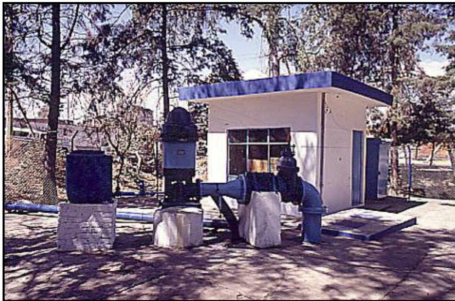
Figura 3.1 Pozo de agua potable
