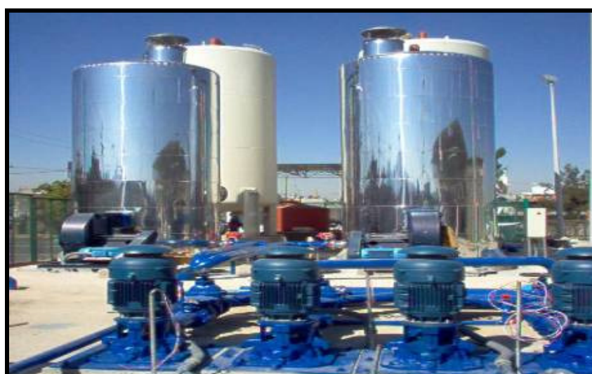
Figura 3.2 Planta potabilizadora “El Sifón”
