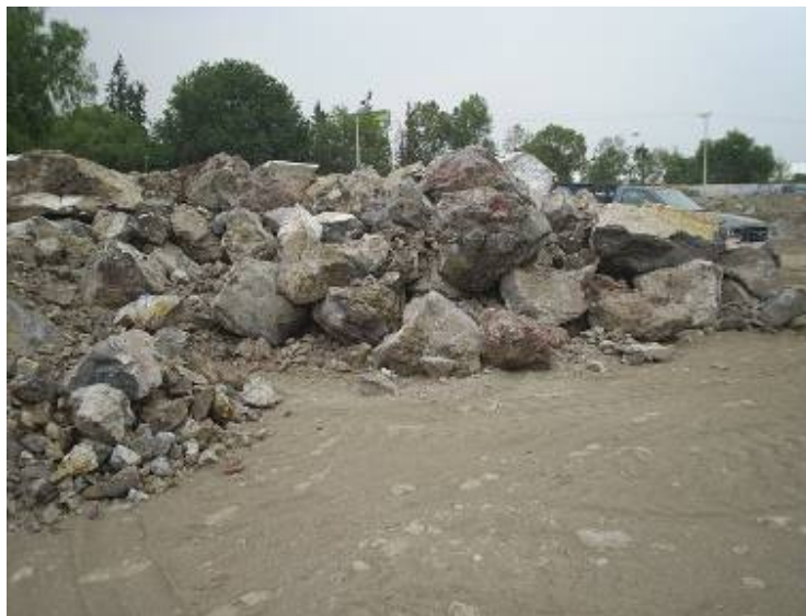
Figura 8.4 Disposición inadecuada de residuos de la construcción
